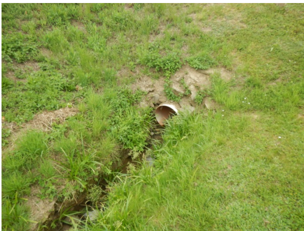
Regenwassereinlauf in der Lochwiese
