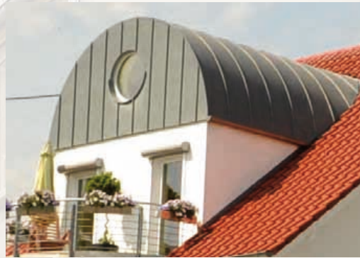
Abbildung: Negativbeispiel Dachgaube
