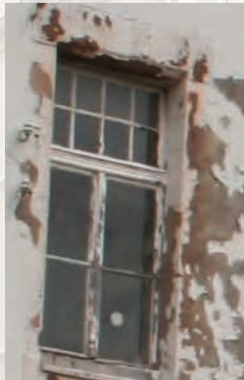
Abbildung: Negativbeispiel Fenstergestaltung
